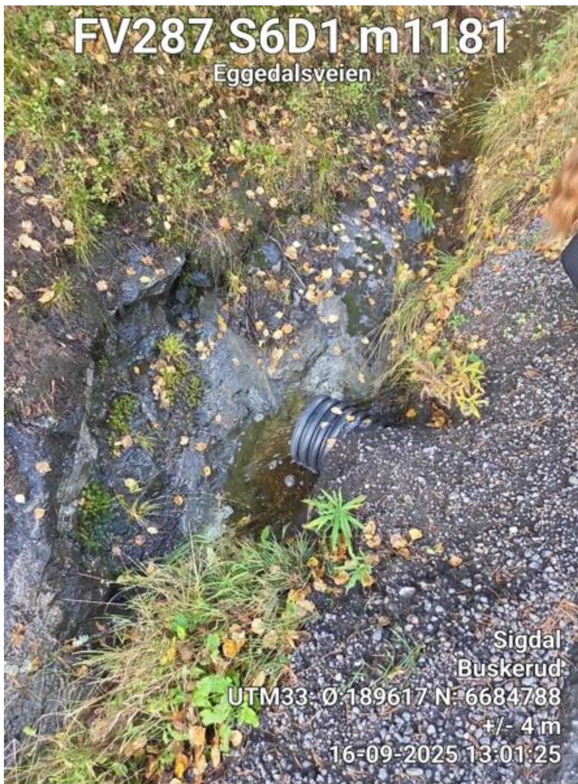
Bilde 18 (over); Drensrør som går gjennom veien. Flere steder vil det i forbindelse med veioppgraderingen, være aktuelt med utsprenning av dypere grøfter og nye rør gjennom veien for bedre drenering.
