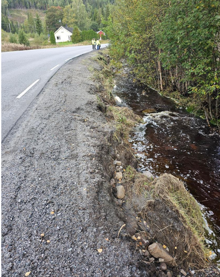
Figur 30. Bilde tatt langs østsiden av veien. Maser har erodert i forbindelse med at kulverten ikke klarte å ta unna for vannet i bekken og vann rant over veien.
