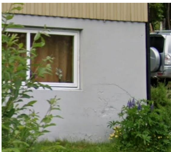
Figur 23 Utsnitt fra Google Street View viser sprekker på kjellervegg i Eggedalsveien 614.
