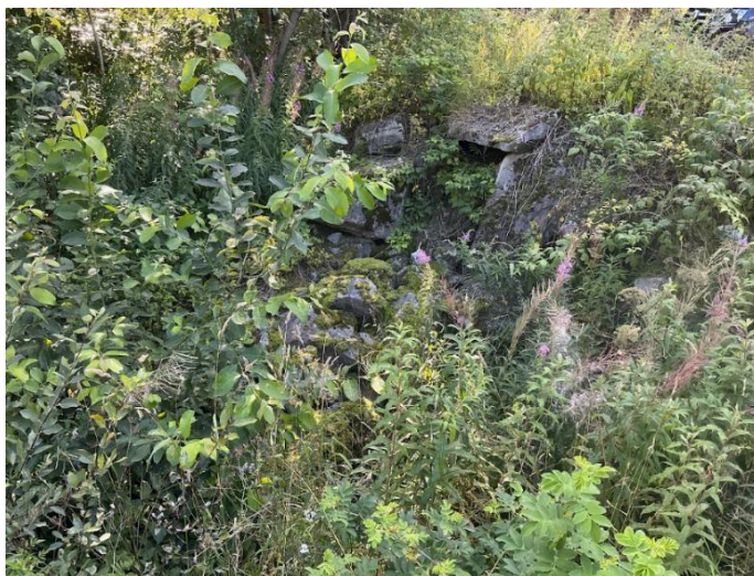
Figur 7-5: Lokalitet 1: Bekk1, bildet er tatt stående på Eggedalsveien med retning oppover bekken. Innløpet er tiltettet av stein, og vann går i overløp over bekken. Stikkrenne planlegges utbedret i prosjektet (pers.komm. ViaNova).
