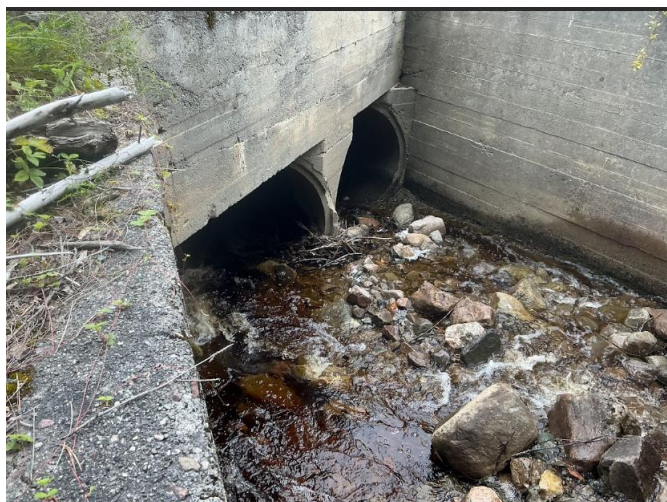
Figur 7-20: Flata 1, oversiden av veien. Der bekken renner inn i kulvertene.
